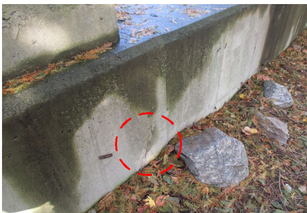
외부 바닥 균열 및 백태 (L=0.5m)
