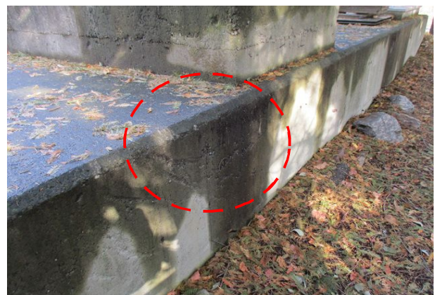
외부 바닥 표면박리 (A=0.5m×0.5m)
