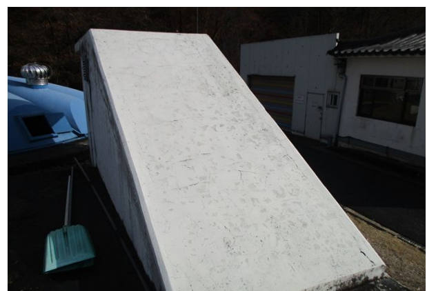
반송오니 펌프실 출입구 망상균열 및 도장박리 (A=1.5m×4.5m)
