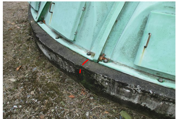
외부 벽체 균열 (CW=0.2mm, L=0.2m, 3EA)
