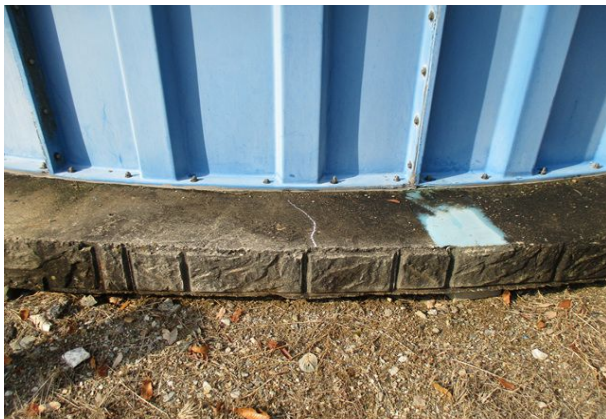
외부 바닥 균열 (CW=0.1mm, L=0.5m)
