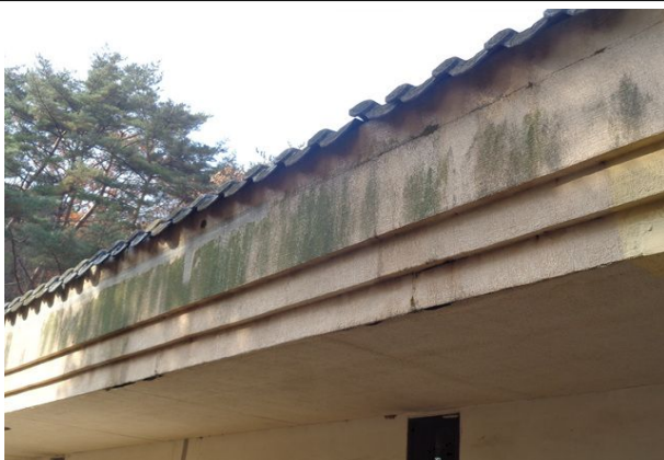
외부 벽체 누수흔적 (A=3.0m×0.5m)
