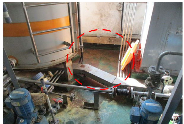
내부 바닥 체수흔적 (A=1.5m×1.5m)
