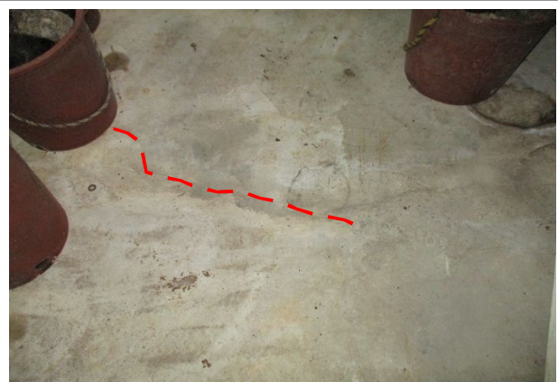
침사지 내부 바닥, 균열 (CW=0.2mm, L=0.5m, 2EA)
