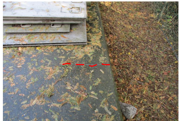
외부 바닥 균열 (CW=0.2mm, L=0.5m)
