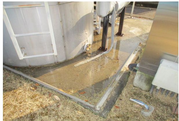
외부 바닥 체수 및 표면박리 (A=2.0m×1.0m)
