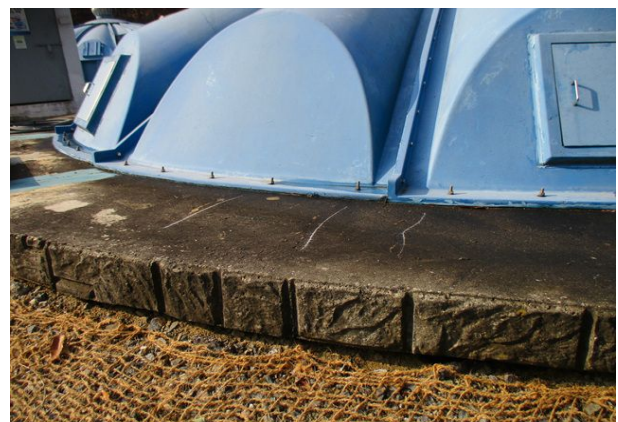
외부 바닥 균열 (CW=0.2mm, L=0.5m, 3EA)
