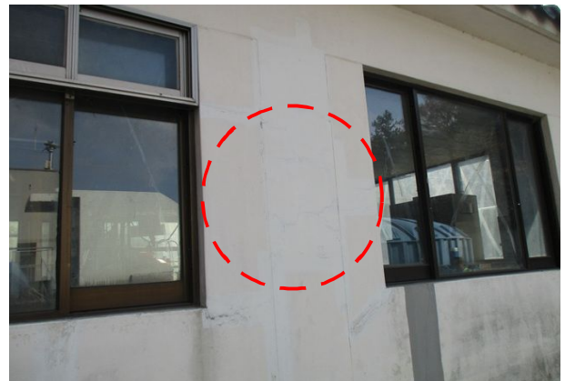
외부 벽체 마감재 망상균열 (A=1.0m×1.0m)
