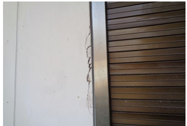
외부 벽체 마감재 파손 (A=0.1m×0.5m)
