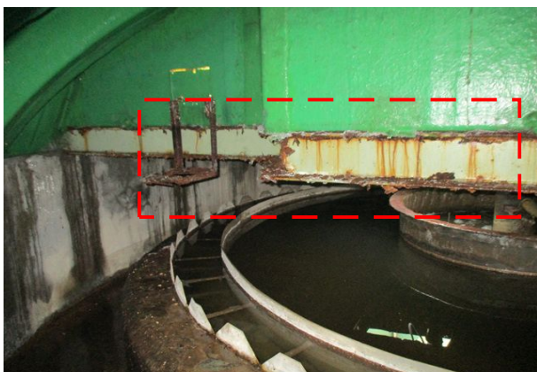
내부 설비 녹발생 (A=3.0m×0.1m)
