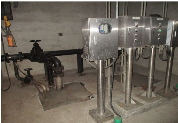
유입펌프장 내부 전경
